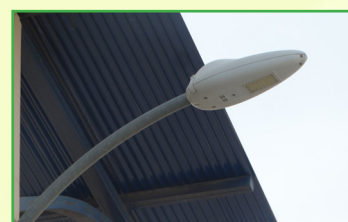
ILUMINAÇÃO ATIVADA POR FOTOCÉLULAS
