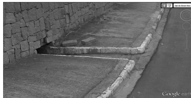
Fonte: Google Earth, 2014. Figura 45 – Escoamento Lateral.
