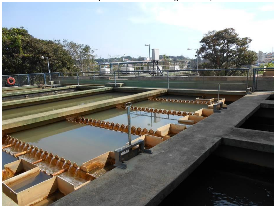
Foto 29 Estação de tratamento de água municipal.
