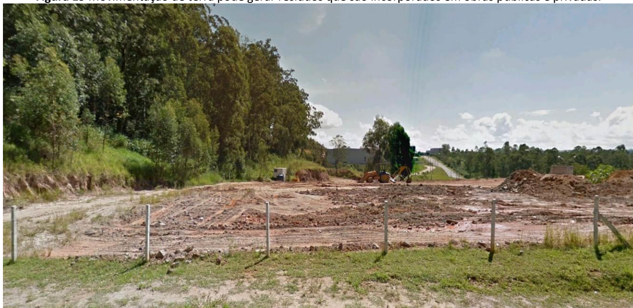
Figura 19 Movimentação de terra pode gerar resíduos que são incorporados em obras públicas e privadas.
