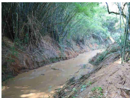
Figura 12.12. Limpeza e desassoreamento da calha do Rio Capivari no Bairro Jd. Niero.
