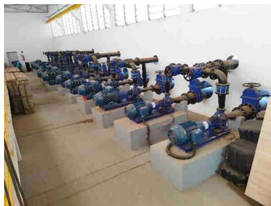
Figura 9.23. Estação Elevatória de Água Tratada Central.
