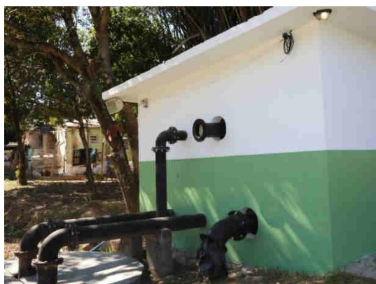
Figura 9.10. Casa de Bombas da EEAB da captação do Córrego Água do Buracão.
