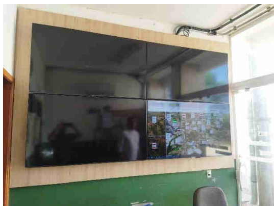
Figura 9.34. Centro de Controle de Operações (CCO) instalado na Estação Elevatória de Água Tratada Central.
