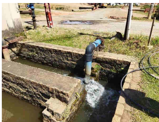
Figura 9.17. EEAB da cap.do Córrego Fetá recebendo água da captação do Rio Capivari.
