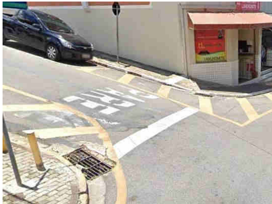
Figura 12.16. Boca de lobo tipo grelha simples sem depressão.
