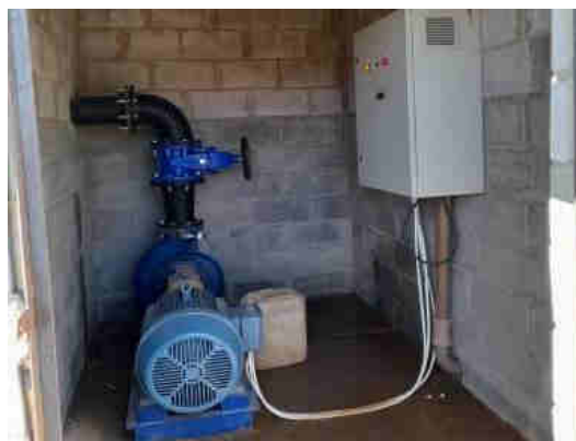
Figura 9.15. EEAB da captação do Rio Capivari.
