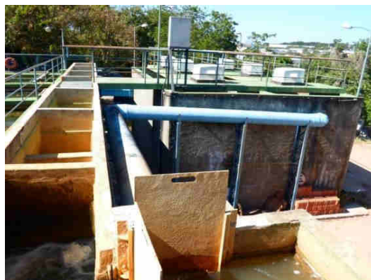
Figura 9.21. Estação de Tratamento de Água - ETA I.
