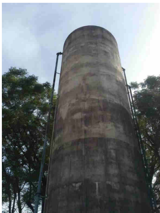
Figura 9.26. Reservatório R22 com não conformidades.
