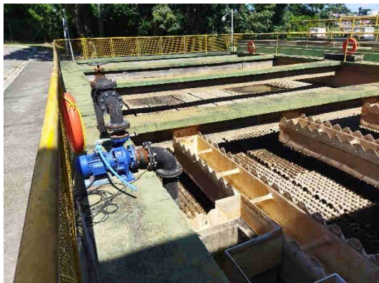
Figura 9.20. Estação de Tratamento de Água - ETA I – Bomba para recirculação.
