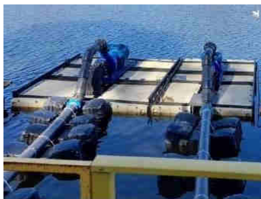
Figura 9.9. EEAB da captação do Córrego do Fetá – Conjuntos Motobomba flutuantes.
