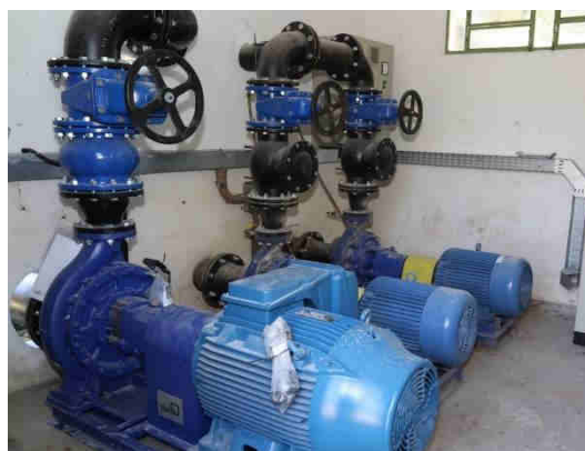
Figura 9.11. EEAB da captação do Córrego Água do Buracão.
