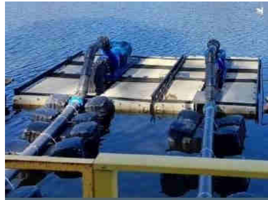
Figura 9.3. Tomada d'água da captação do barramento do Córrego Fetá.
