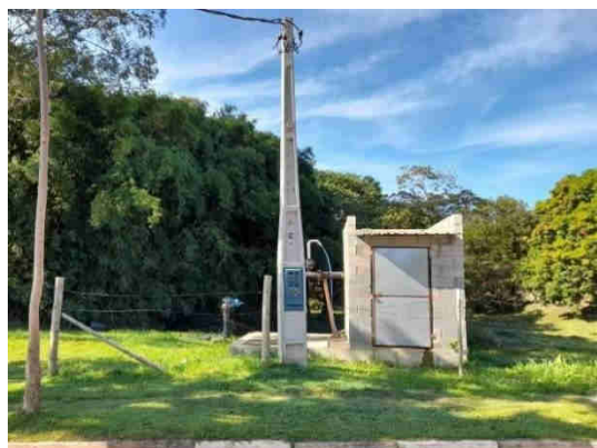
Figura 9.6. Casa de bombas da captação do Rio Capivari.
