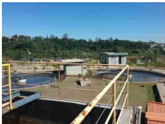
Figura 10.5. Guarda-Corpo do tanque de aeração com não conformidades.
