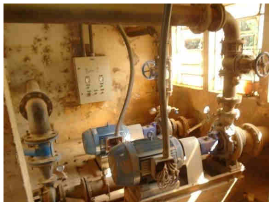
Figura 9.12. Casa de Bombas da EEAB da próximo da EEATC.
